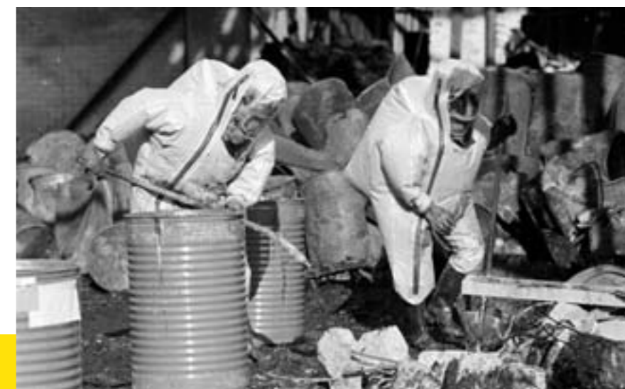
Mit Schutzanzügen versuchte man, das Unglück in Schweizerhalle zu beseitigen. Heute zeigt sich, dass die damalige Sanierung nur halbherzig durchgeführt wurde.
